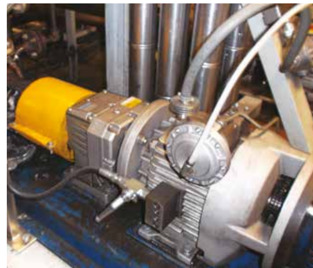
Instalación química: variador K5 con control remoto neumático
